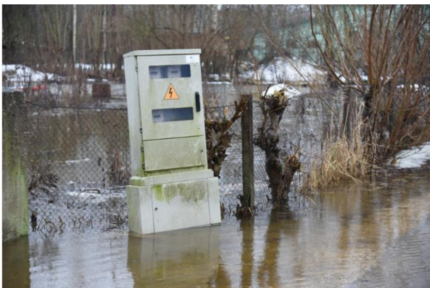
5.2. attēls. Elektroapgādes infrastruktūra plūdos, Jēkabpils, 2023. gads.
